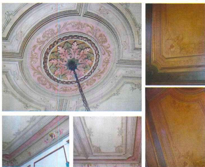
Detalle de pintura mural.
